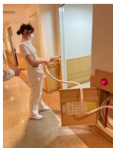
消火栓で初期消火
